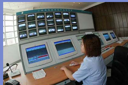
三峡永久船闸系统主控中心
