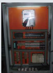
图2: 安装在控制室的BW500积算仪
