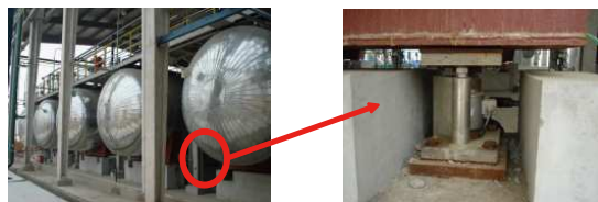
图 3 液氯储罐传感器安装实物图
