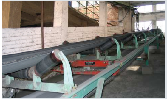
13. 皮带秤的安装现场
