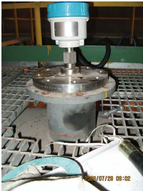
图5 导波雷达在首钢京唐钢厂现场
