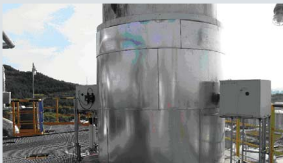
图 2: 现场安装的LDS6 激光气体分析仪探头
