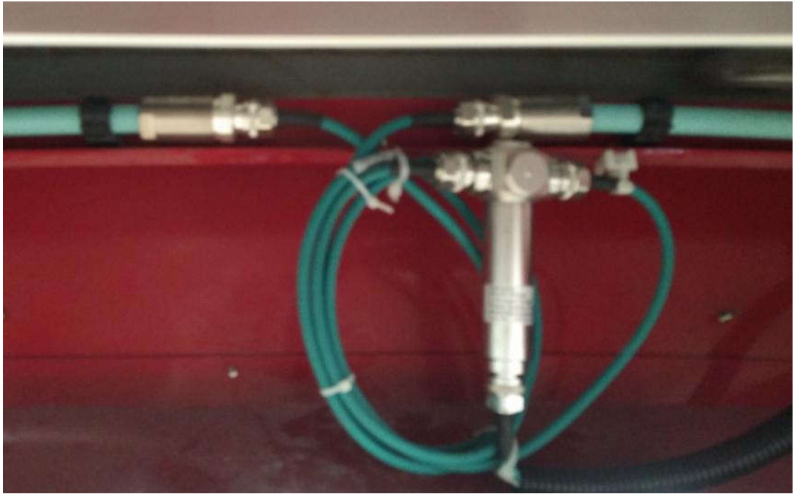
漏波电缆尾端终端电阻
