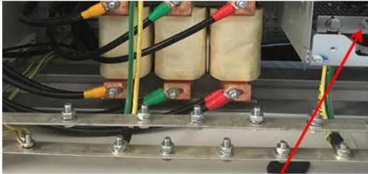
变频器逆变侧动力电缆屏蔽层的接地处理。
