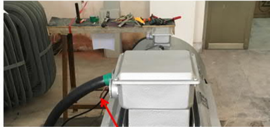
电机侧动力电缆屏蔽层的接地处理。
