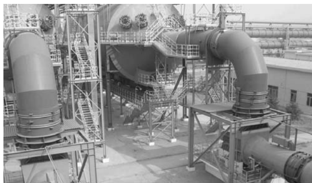
图 1 天铁集团 LDS6 安装位置示意(一): 电除尘设备
